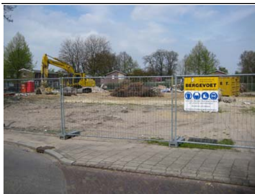
Figuur 2.1 Resten van het schoolgebouw in het plangebied, gezien vanaf de Essenkampstraat
