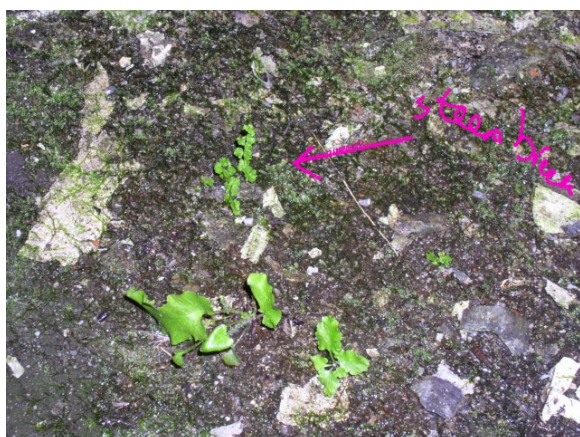
Foto 2: Steenbreekvaren en Tongvaren (op voorgrond) in de schuur met lekkend dak
